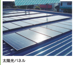
太陽光パネル
