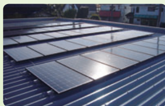
太陽光パネル
